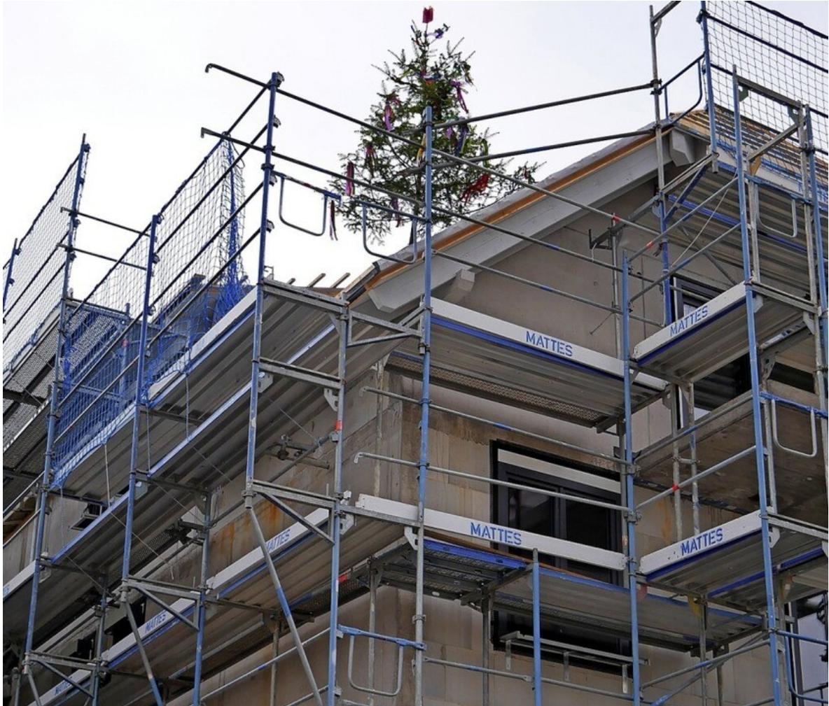
Das Bäumchen auf dem Dach kündigt vom Abschluss der Rohbauarbeiten am Genossenschaftshaus in Harpolingen. Foto: Michael Gottstein
